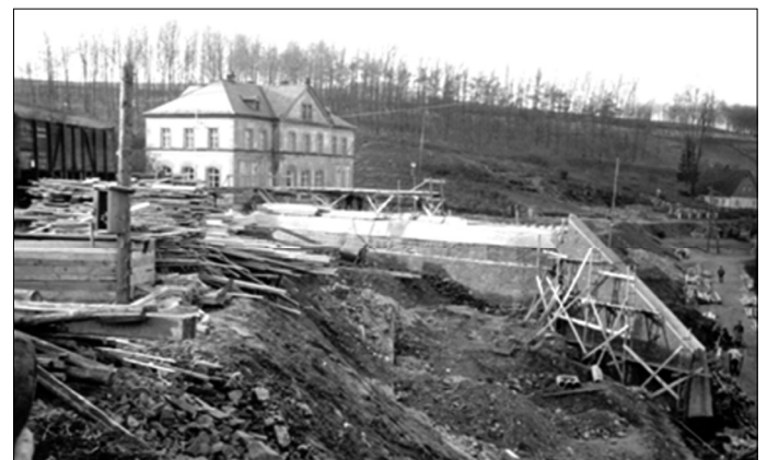
Blick auf den Bau der Unterführung des Weges „Am Schulberg“ mit Bahndammaufschüttung
